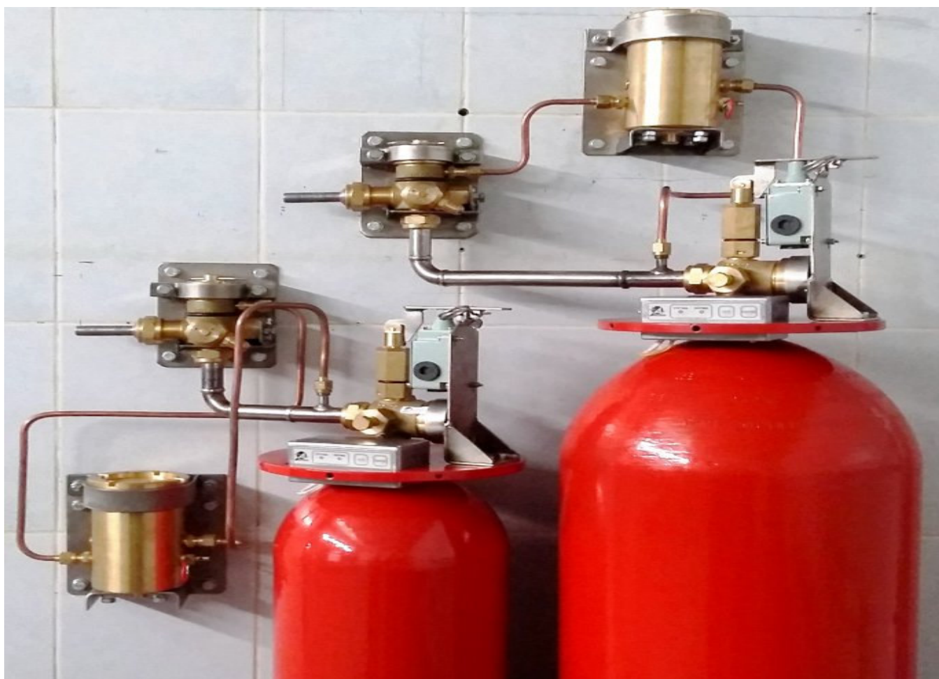
Устройство газового пожаротушения на два направления
