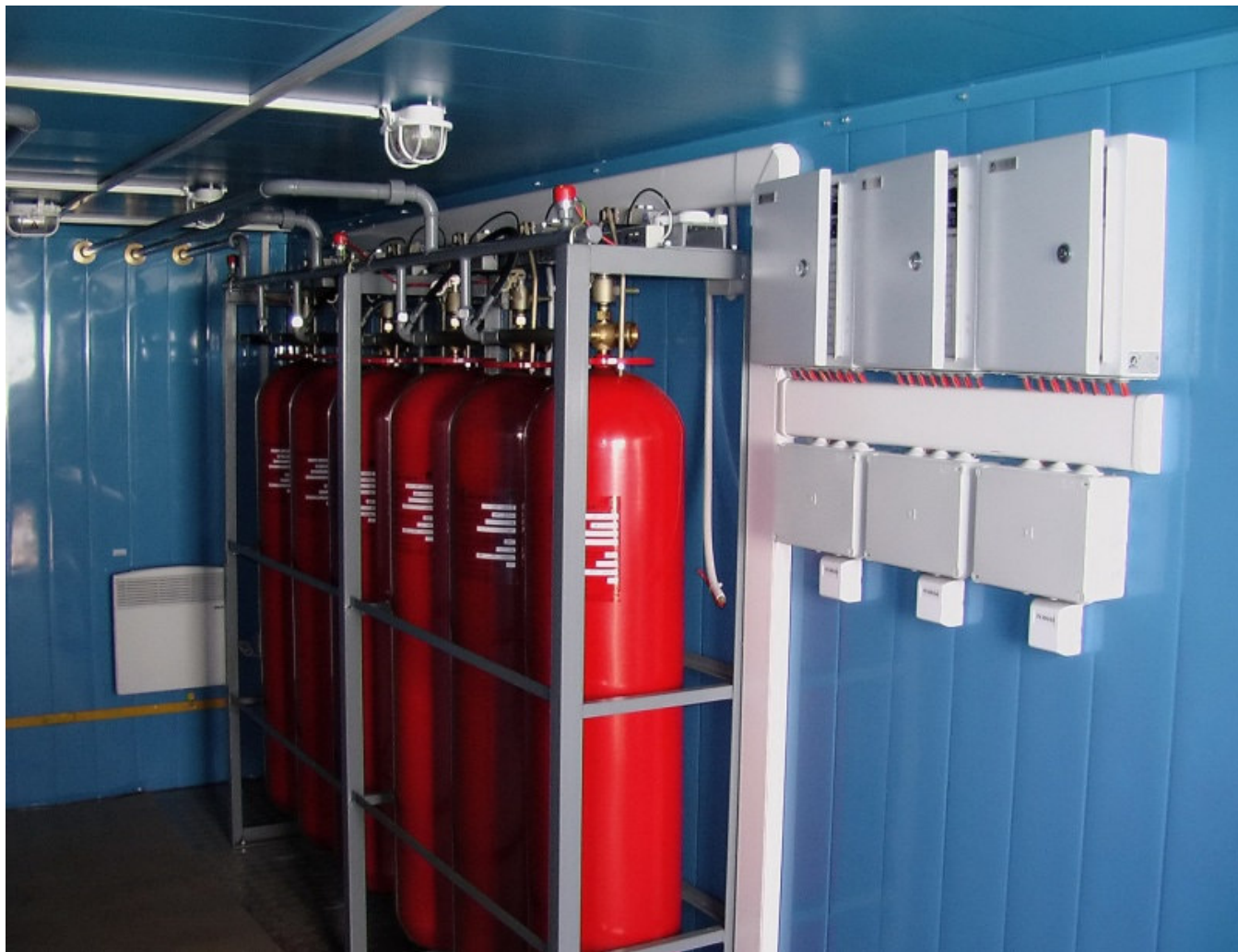
Смонтированные модули газового пожаротушения
